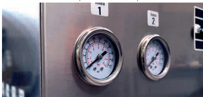
Particolare dei manometri per il controllo della pressione
